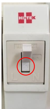
รูปภาพที่ 4- 28 สะพานไฟที่ใช้ในการส่งผ่านกระแสไฟฟ้าไปยังเครื่องขยายเสียงประจำห้องเรียน
