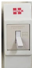
รูปภาพที่ 4- 26 สะพานไฟควบคุมไฟฟ้าประจำชุดเครื่องขยายเสียงประจำห้องเรียน
