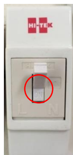
รูปภาพที่ 4- 11 สะพานไฟที่ใช้ในการส่งผ่านกระแสไฟฟ้าไปยังเครื่องโปรเจคเตอร์ (Projector) ประจำห้องเรียน
